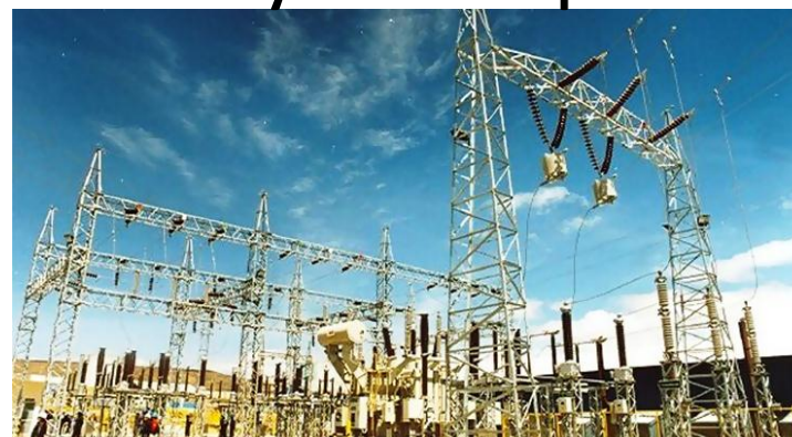
Línea de Transmisión Moyobamba-Iquitos
